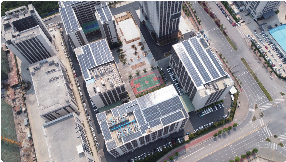
惠州工厂的屋顶光伏发电装置
